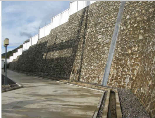
吉龙变电站排水及拦挡
