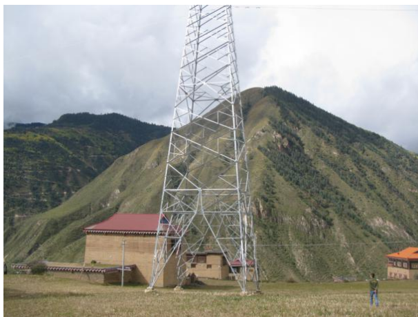
吉共线路塔基面貌（2018.10）
