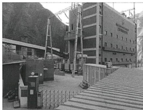
220kV 杨房沟变电站
