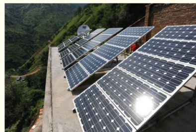
2台站太阳能供电和卫星传输设备
