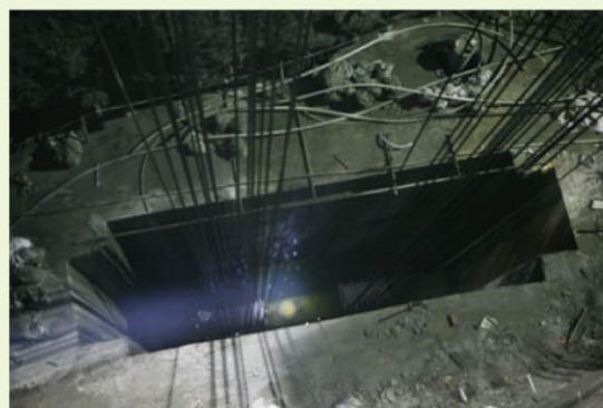
启闭机准备开启尾水事故闸门冲水阀
